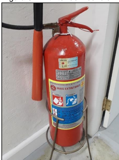
Figura 6 - Extintor de incêndio
