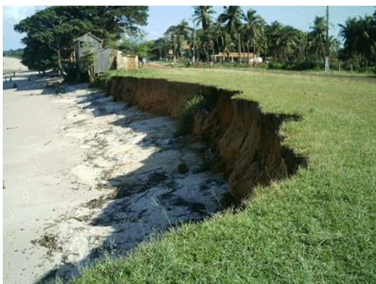
Figura 9 – Erosão, Praia Grande – Salvaterra. Casa de madeira na orla.
