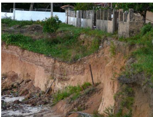
Figura 8 – Erosão, Desmoronamento de Imóveis e Rua Interditada.
