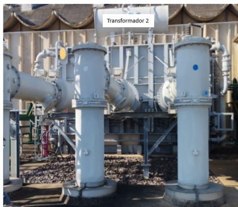
Figura 8 – Transformador de potência - T2.
