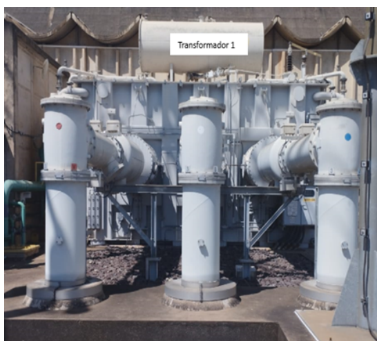
Figura 7 – Transformador de potência - T1.
