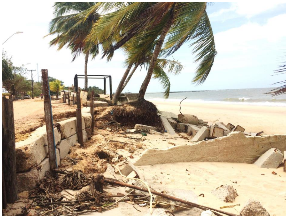
Figura 21 - Processo de erosão nas proximidades do perfil F em novembro de 2016.
