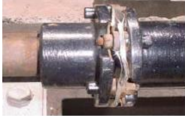
Figura 35. Acoplamento danificado por desalinhamento.
