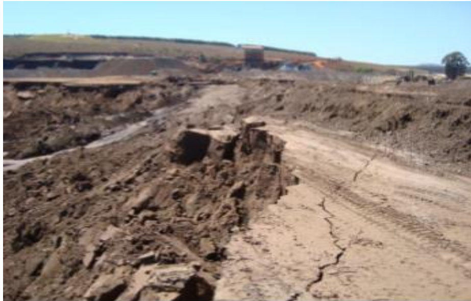
Figura 23 - Vista do local no lago de deposição de rejeitos da B1 no limite da ruptura e trinca longitudinal.
