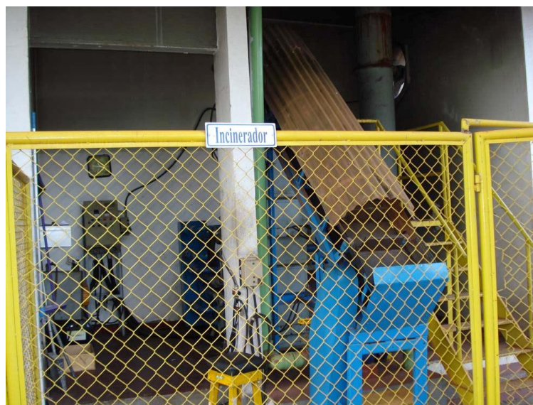
Figura 5.1-3. Incinerador LUFTECH modelo RGL 200 S com adaptação. Fonte: MRN
