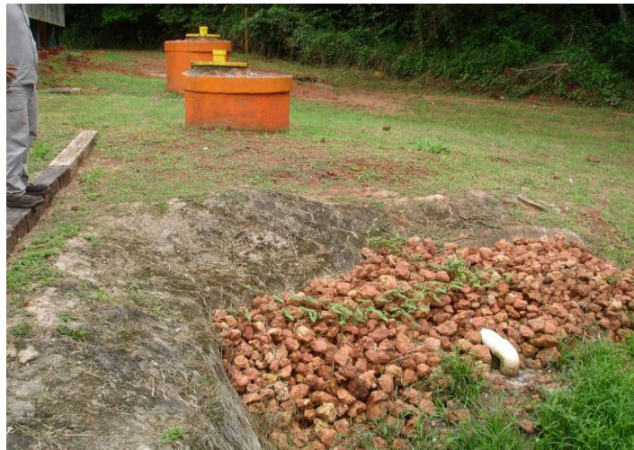
Figura 5.5.1-3. Tratamento de chorume da UTC Fonte: MRN
