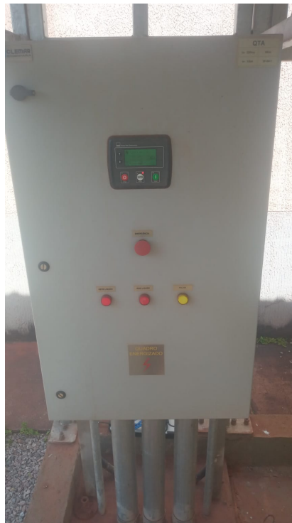
Figura 8 – QTA Instalado para Automatização dos Geradores.
