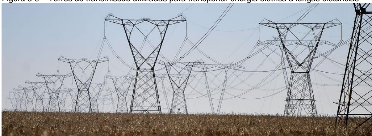
Figura 3-9 – Torres de transmissão utilizadas para transportar energia elétrica a longas distâncias
