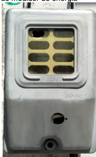
Figura 4-1 – Caixa protetora do medidor de energia
