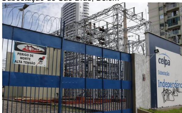
Figura 3-12 – Subestação do Independência ou Subestação de São Brás, Belém
