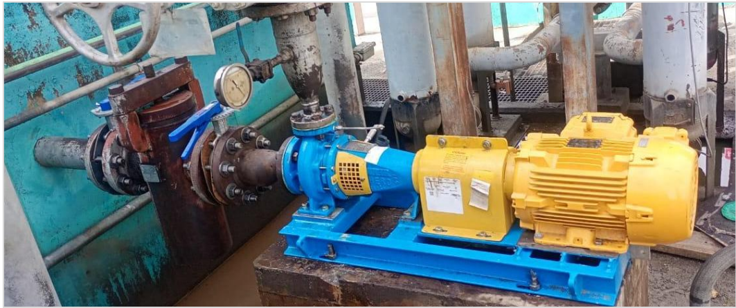
Figura 5 — Bomba de Abastecimento
