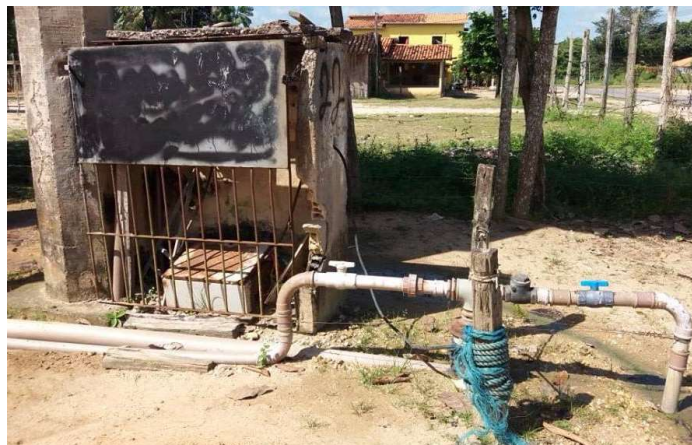
Figura 8 - Estrutura de bombeamento da água subterrânea para a Residência Local.
