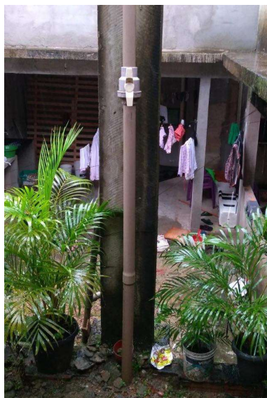
Figura 9 - Estrutura de bombeamento da água subterrânea para a residência.
