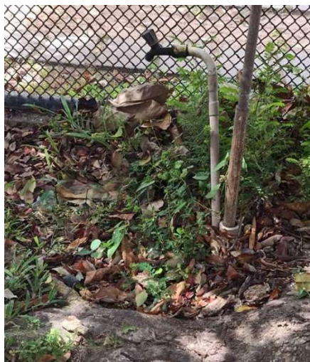
Figura 6 - Torneira d'água com captação direta do aquífero subterrâneo.
