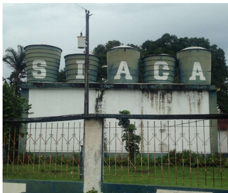
Figura 10 - Caixas d'água que armazenam a água subterrânea captada para distribuição para população local.
