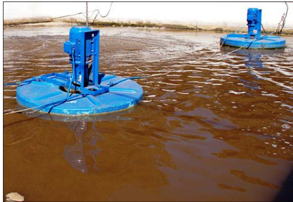
Figura 10: Tanque de equalização e Aeradores flutuantes.
