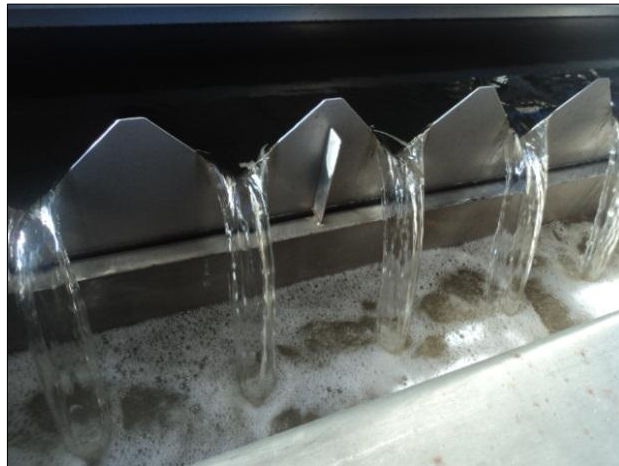
Figura 11: saída do efluente tratado.
