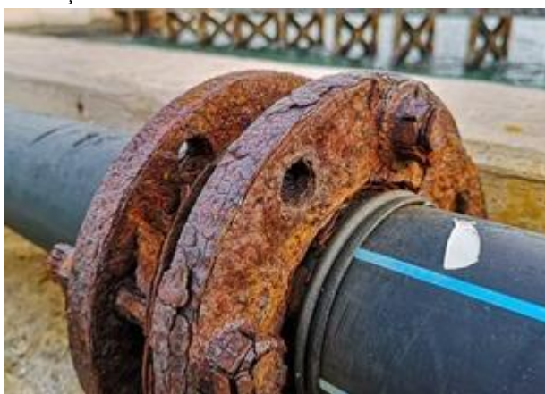
Figura 2 - Corrosão uniforme no aço carbono.
