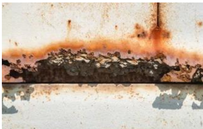
Figura 4 - Corrosão por fresta de aço carbono.
