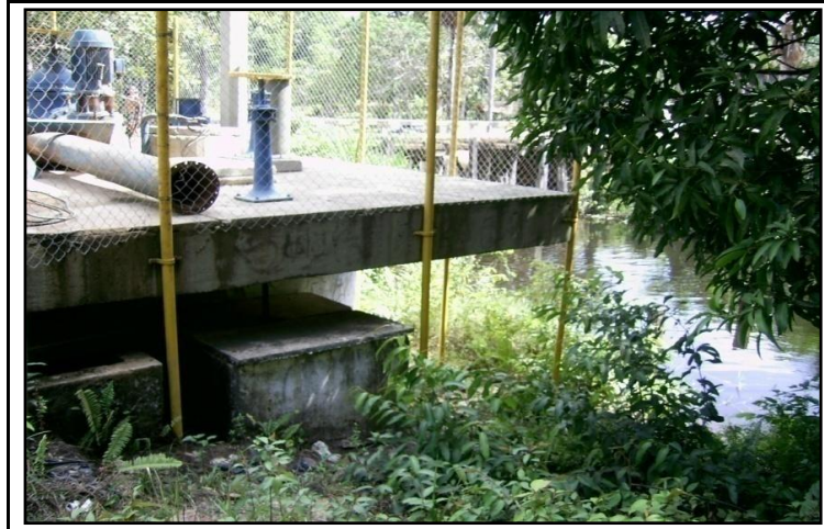
Figura 14 – Adutora de água do rio Chumucuí, com evidentes indicações de falta de manutenção.– Bragança: Pará.
