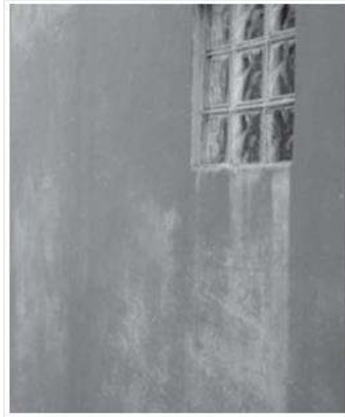
Figura 19 – Manchas esbranquiçadas causadas por eflorescências
