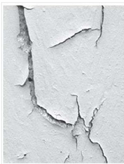
Figura 17 – Descascamento de pintura
