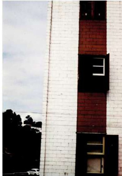
Figura 05 – Destacamento entre paredes por assentamento dos blocos com juntas a prumo e movimentações higroscópicas
