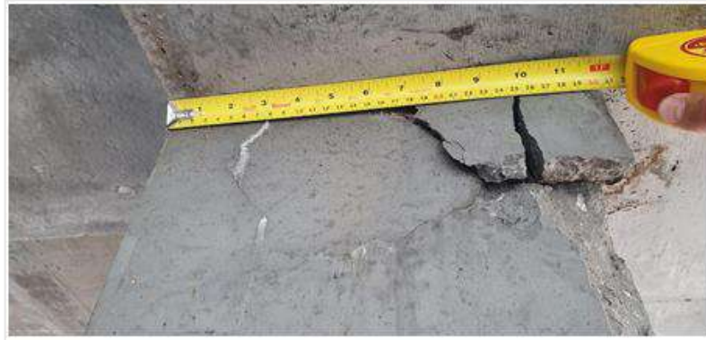
Figura 09 – Esmagamento da cabeça do pilar por sobrecarga
