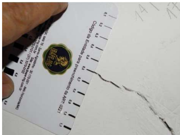
Figura 02 – Trinca com espessura de 0,6mm
