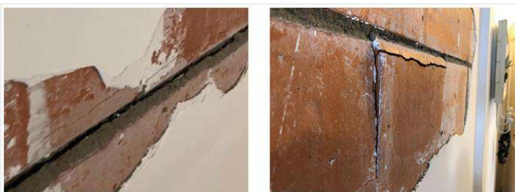
Figura 16 – Fissuras e lascamentos em blocos cerâmicos causados por higroscopicidade do material
