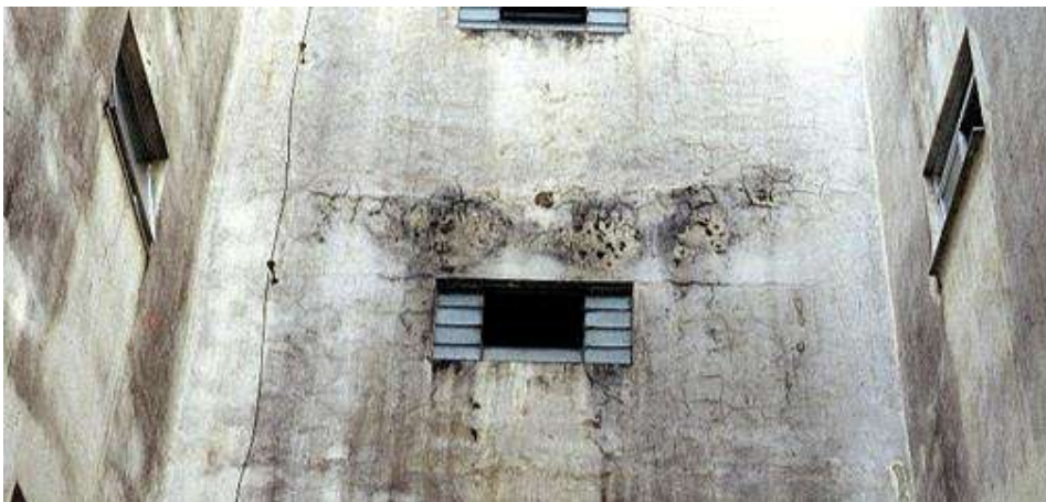
Figura 06 – Processo de degradação do revestimento e fissuras mapeadas devido a umidade constante
