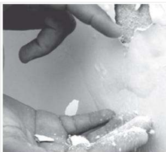
Figura 18 – Desagregação da pintura
