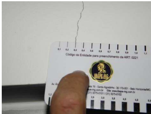
Figura 01 – Fissura com espessura de 0,3mm
