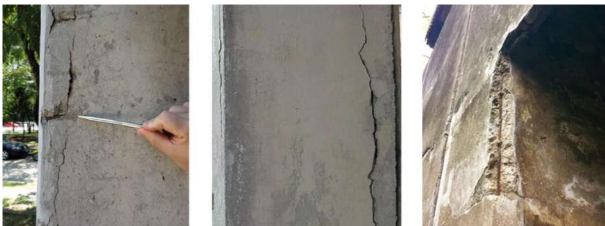
Figura 12 – Corrosão de armaduras
