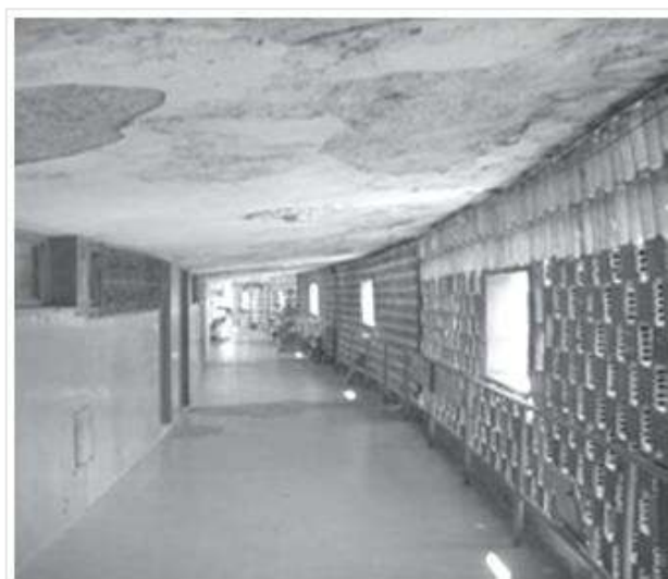
Figura 14 – Desagregação de revestimento no teto
