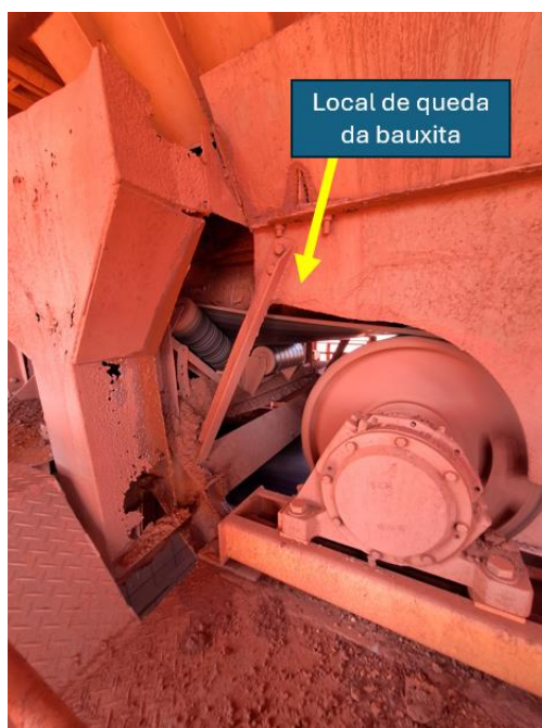
Figura 16 - Local de queda da bauxita.
