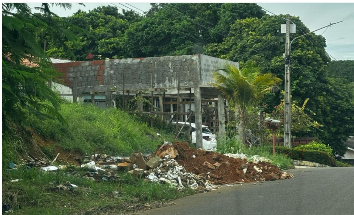
Figura 15 – Resíduos de construção civil descartados sem controle
