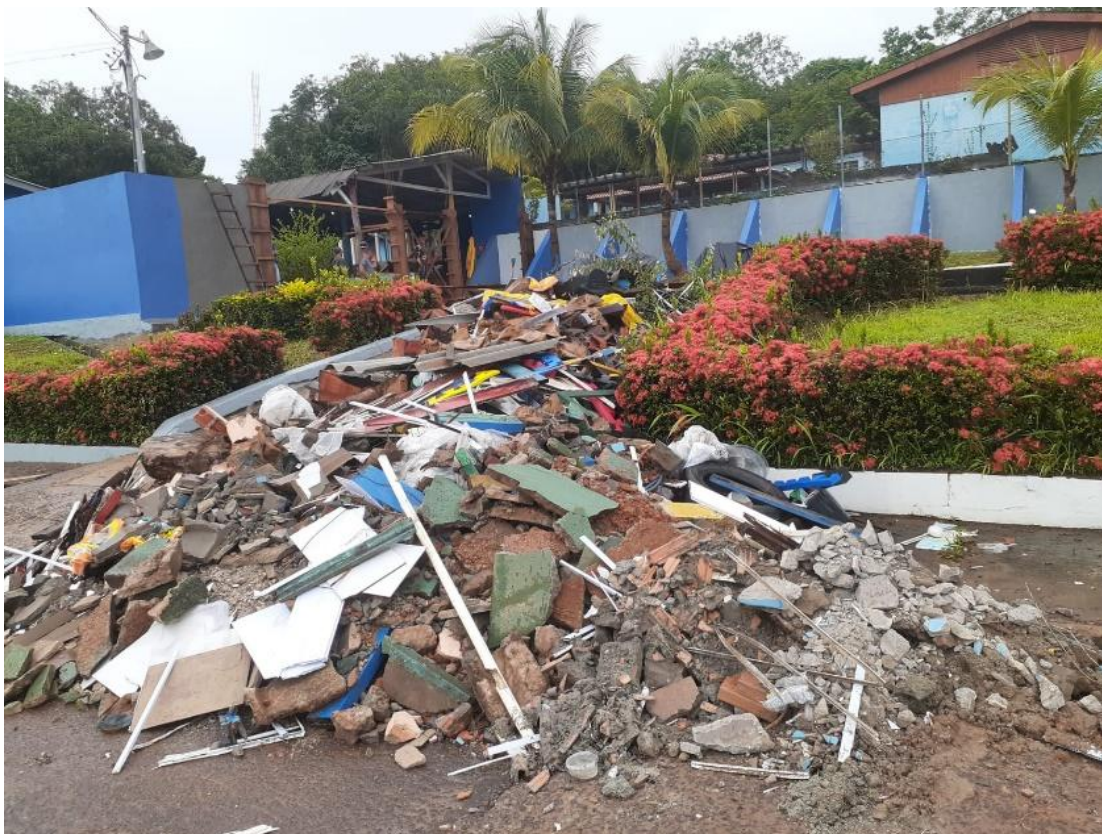
Figura 17 – RCD sem acondicionamento adequado em obras de construção civil
