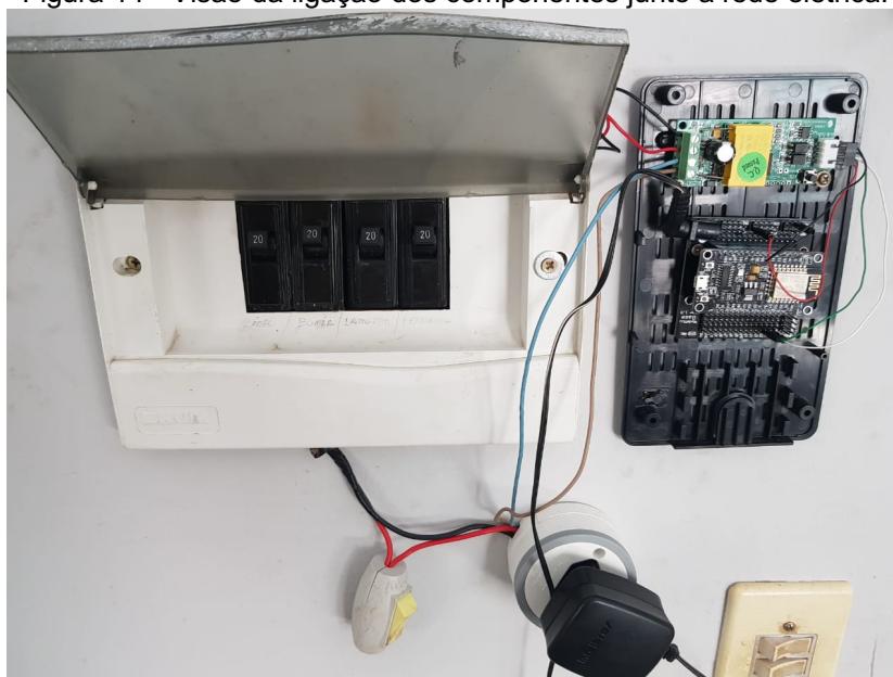
Figura 14 - Visão da ligação dos componentes junto a rede elétrica.
