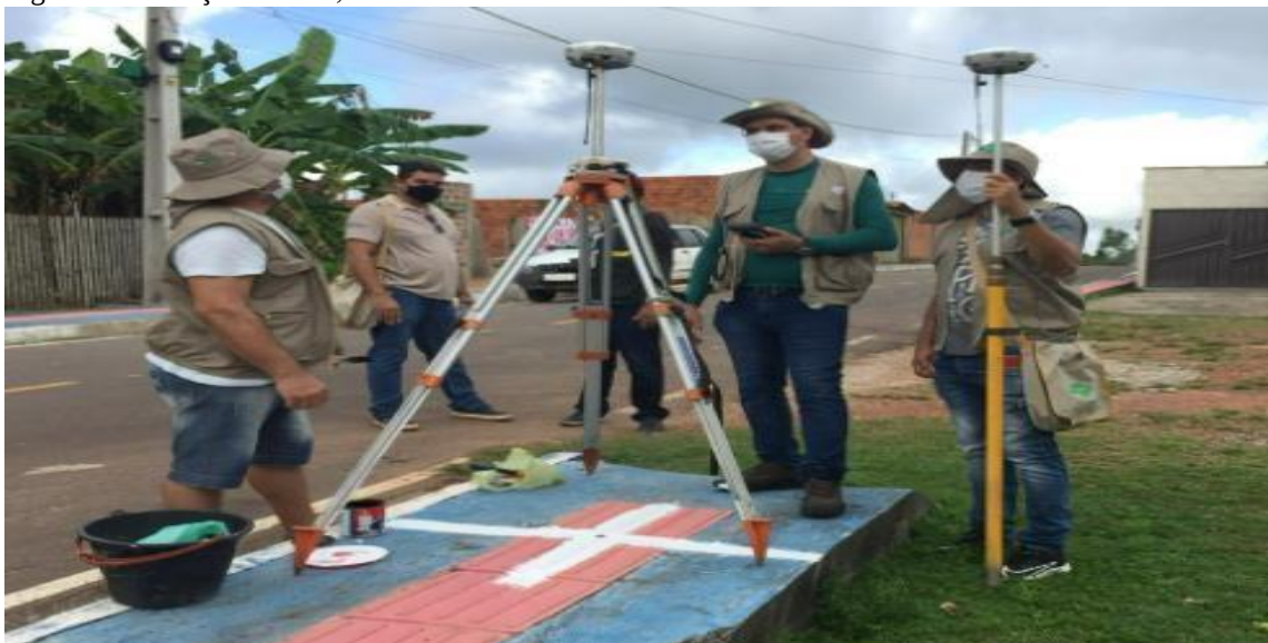
Figura 3: Instalação da base, GNSS módulo RTK
