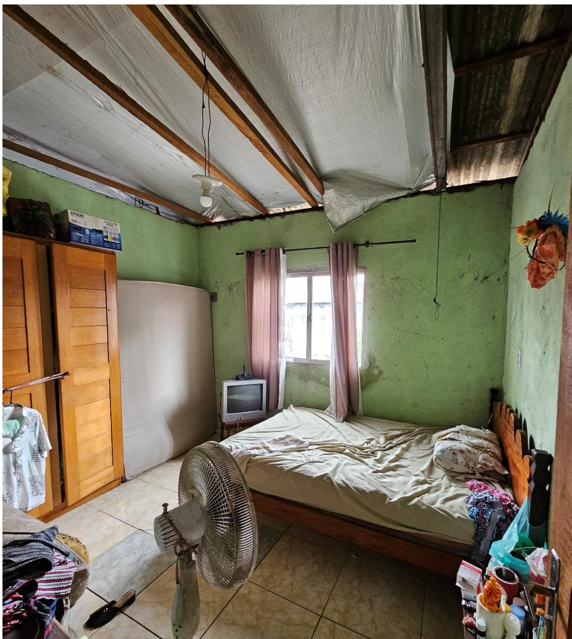
Figura 18 – Cobertura, sem forro e com manta improvisada, 2025.
