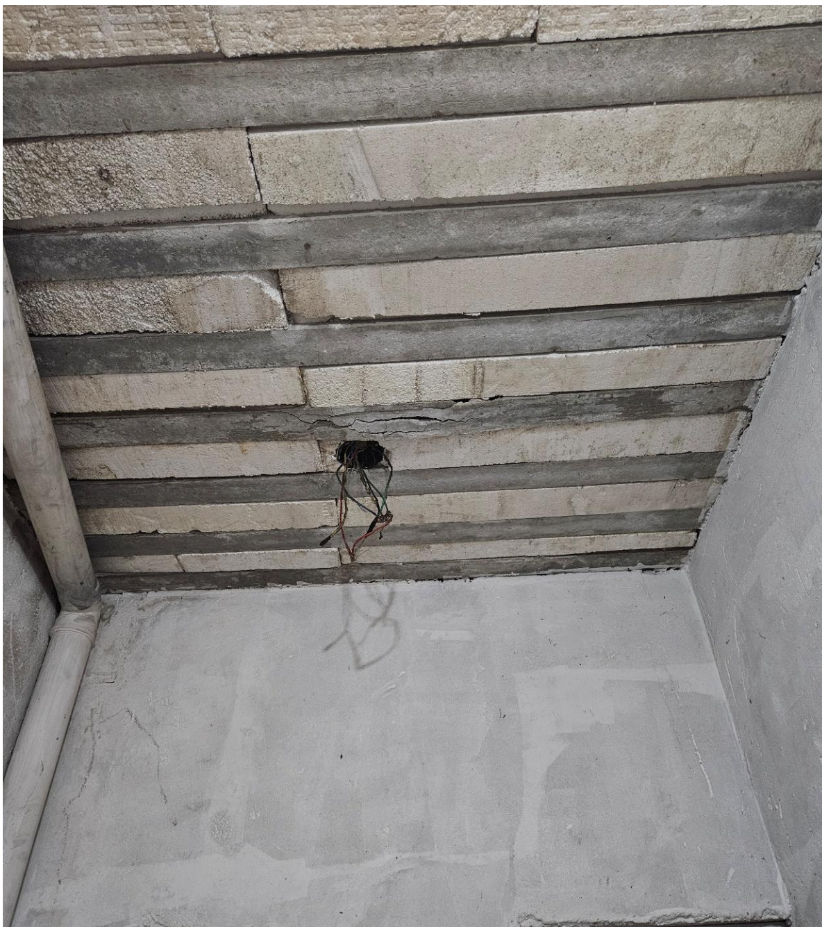
Figura 20 – Instalação elétrica exposta, 2025.
