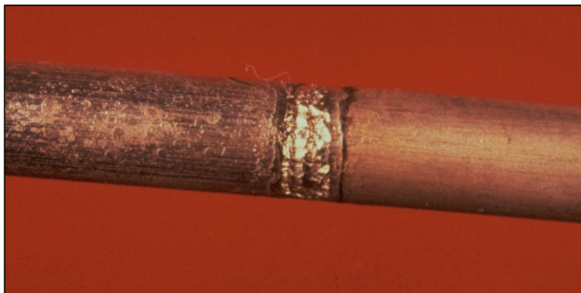
Figura 16. Tubo de aço e cobre sob processo de desgaste corrosivo geral e galvânico.
