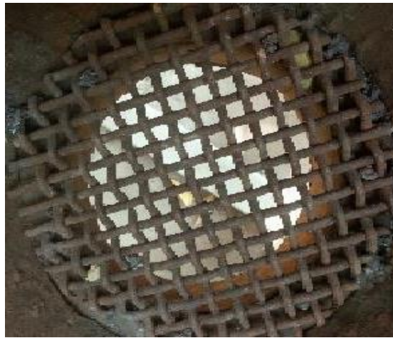
Figura 18 – Grelha de aço carbono.
