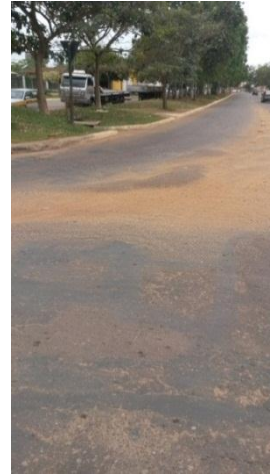
d) Defeitos diversos, 6m x 3,5m (Avenida Veridiano Cardoso)
