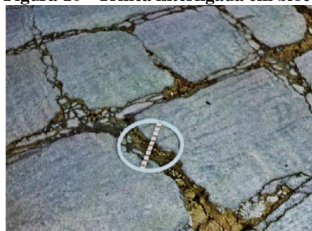
Figura 10 - Trinca interligada em bloco
