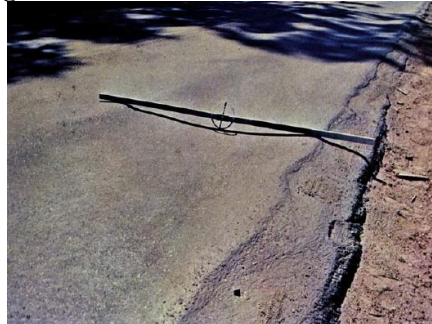
Figura 11 - Afundamento na trilha de roda
