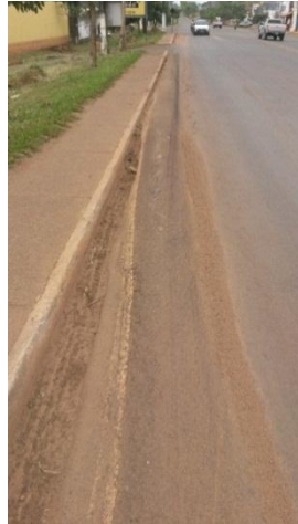
c) Afundamento na trilha de roda com ondulação, 6m x 0,5m (Avenida Veridiano)
