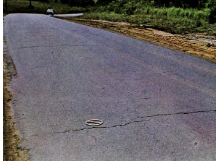
Figura 7 - Trinca isolada - transversal
