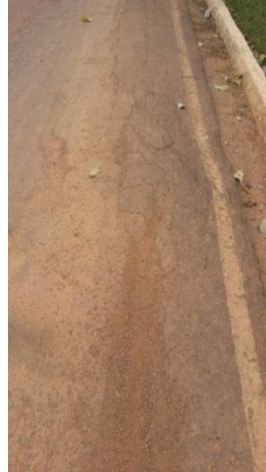
b) Trincas longitudinais interligadas, 6m x 0,5m (Rua Tancredo Neves)
