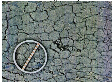
Figura 9 - Trinca interligada - tipo couro de jacaré
