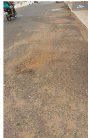
f) Desgaste 6m x 2,5m (Rua Santo Antônio)
