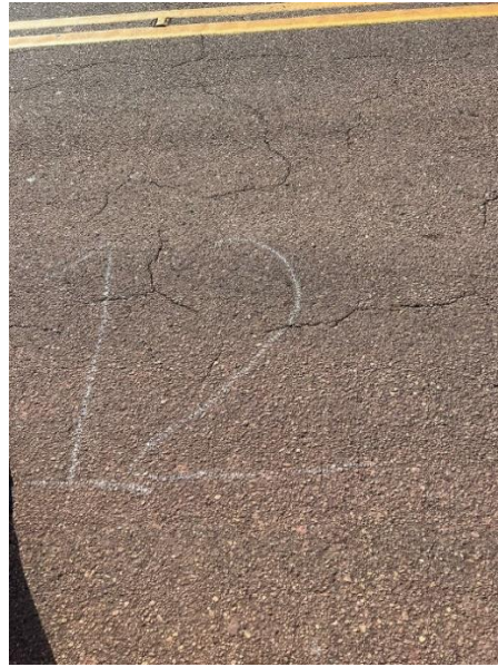
Figura 29 – Defeitos encontrados no trecho 3 (estação 12)
