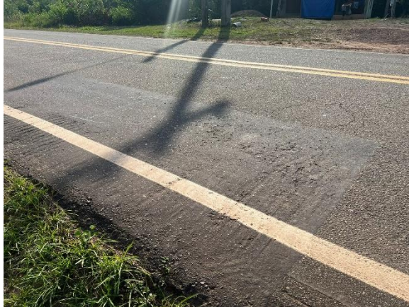
Figura 27 – Defeitos encontrados no trecho 3 (estação 1)
