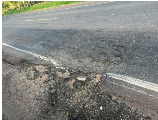
Figura 24 – Defeitos encontrados no trecho crítico (estação 16)
