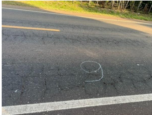
Figura 25 - Defeitos encontrados no trecho crítico (estação 9)
