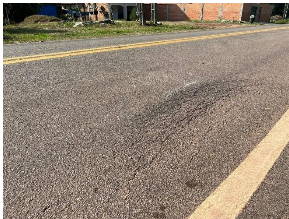
Figura 28 – Defeitos encontrados no trecho 3 (estação 11)
