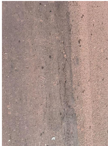
Figura 32 - Trincas na borda do remendo
