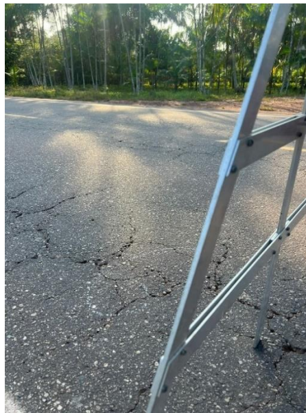
Figura 26 - Defeitos encontrados no trecho crítico (estação 6)
