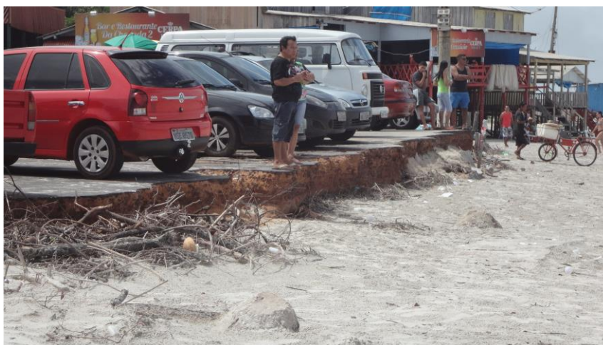
Figura 11 - Erosão na praia de Crispim com presença de veículos na zona pós praia alterada para obra de asfaltamento.*
