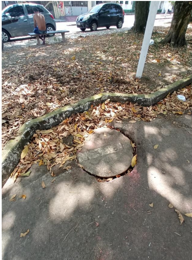
Figura 20 – Exemplo de tampas de poços de visita
