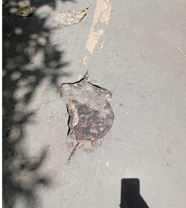
Figura 15 – Exemplo de buraco em pavimento rígido
