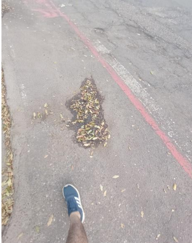
Figura 22 – Exemplo de afundamento
