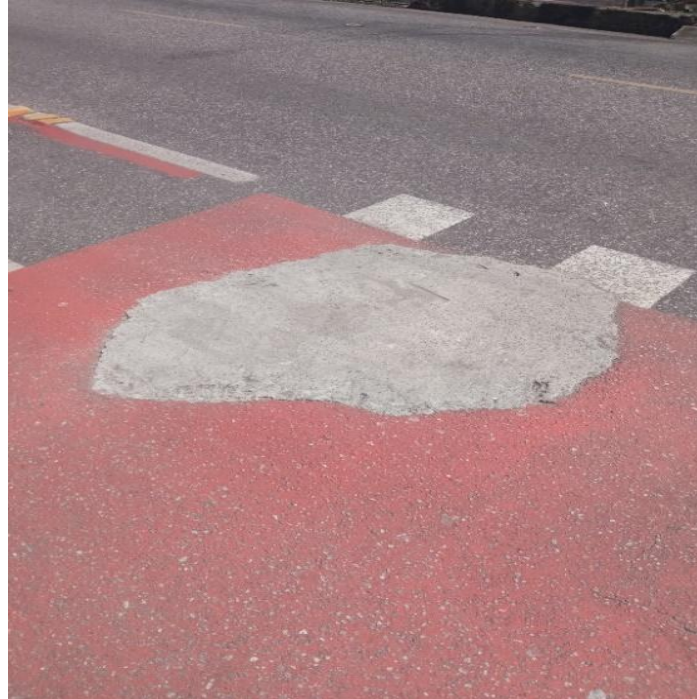
Figura 18 – Exemplo de remendo no pavimento flexível
