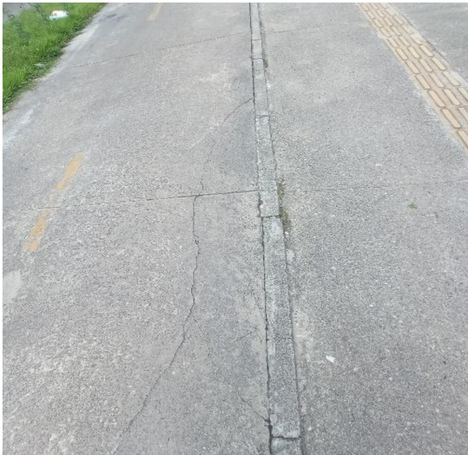
Figura 13 – Exemplo de fissuras, trincas e rachaduras isoladas no pavimento rígido
