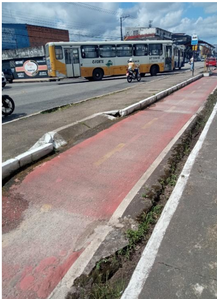
Figura 25 – Exemplo de desnível entre via ciclável e sarjeta
