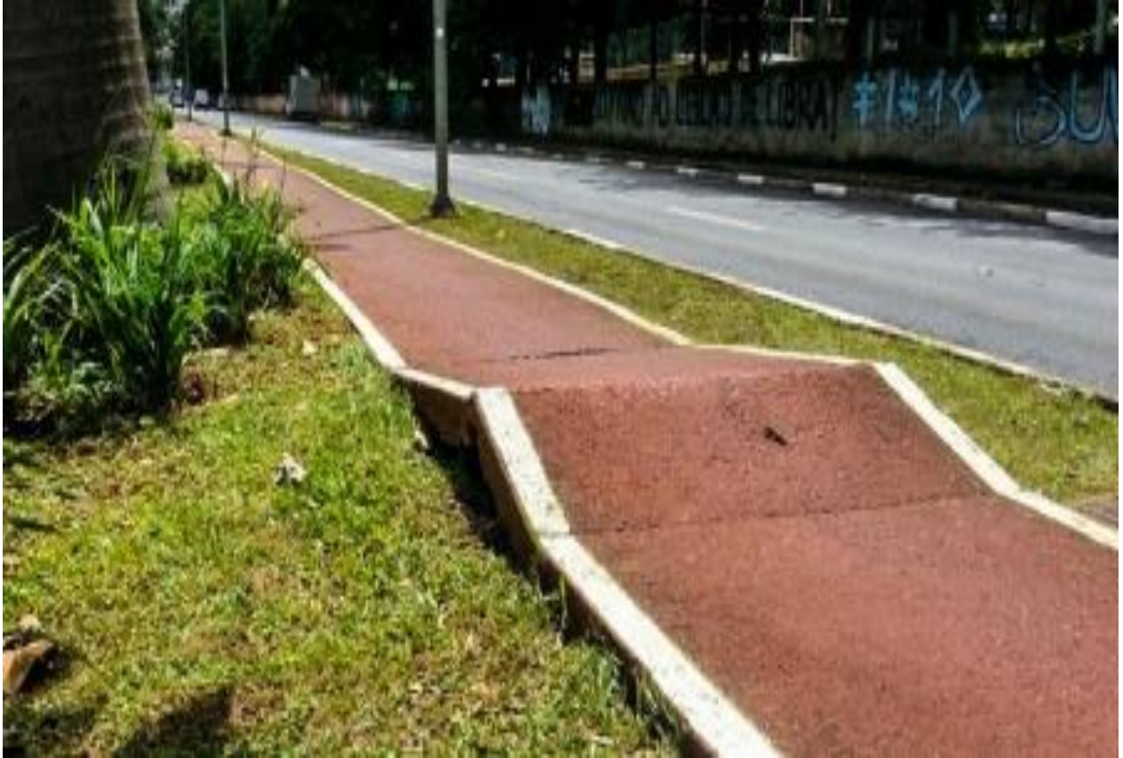
Figura 36 – Exemplo de alçamento ou esmagamento das placas
