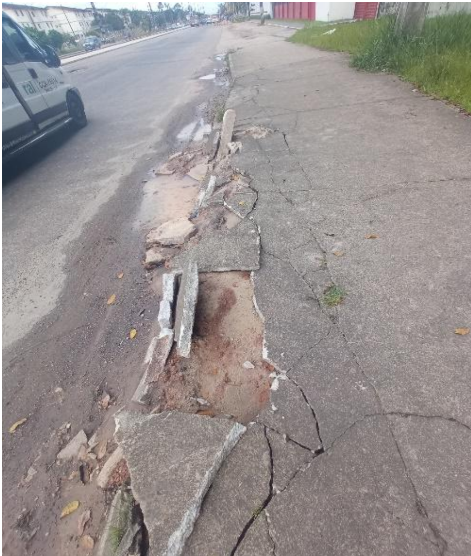
Figura 30 – Exemplo de quebras
