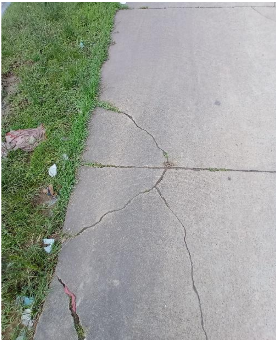
Figura 31 – Exemplo de quebras
