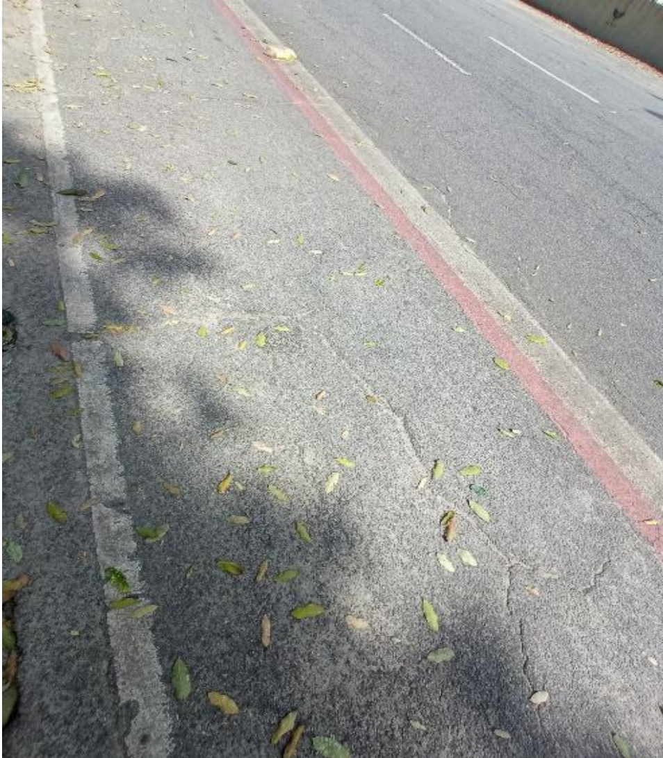
Figura 14 – Exemplo de fissuras, trincas e rachaduras isoladas no pavimento flexível
