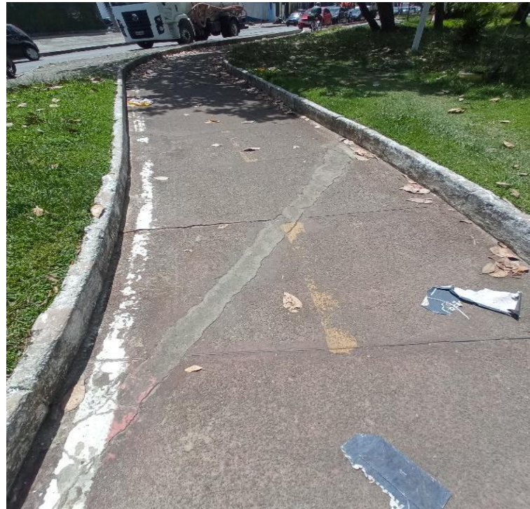
Figura 19 – Exemplo de remendo no pavimento rígido
