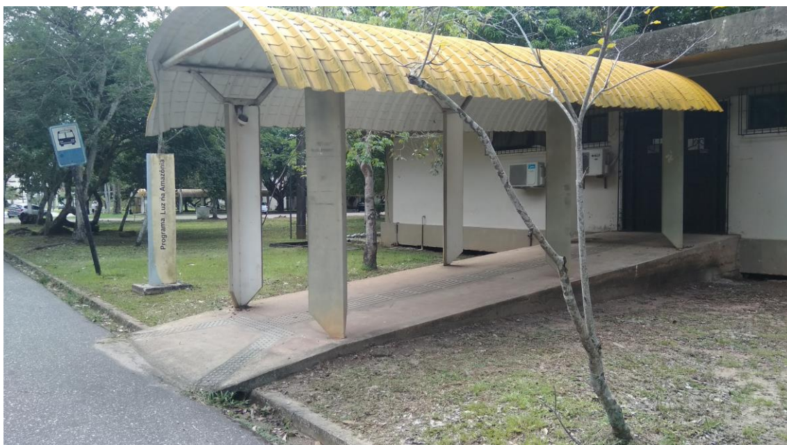
Figura 22 - Exemplo de conexão insatisfatória entre leito carroçável e passarela, e rampa sem patamar em frente à porta de entrada, em prédio no Setor de Saúde
