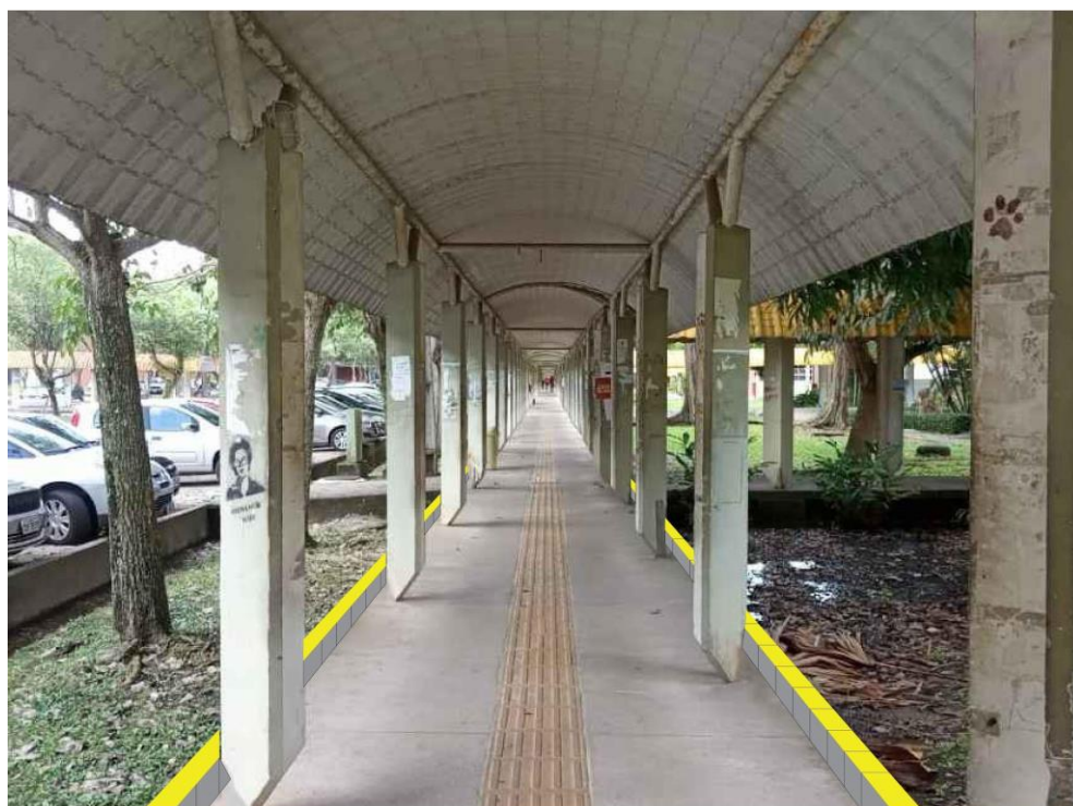
Figura 21 - Proteção contra quedas nas passarelas
