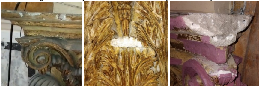
Figura 13: mapeamento de áreas danificada do capitel.
