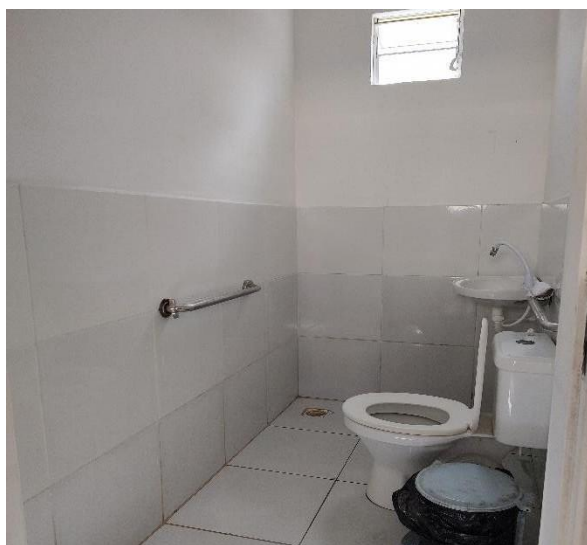
Figura 04- Banheiro adaptado na parede
