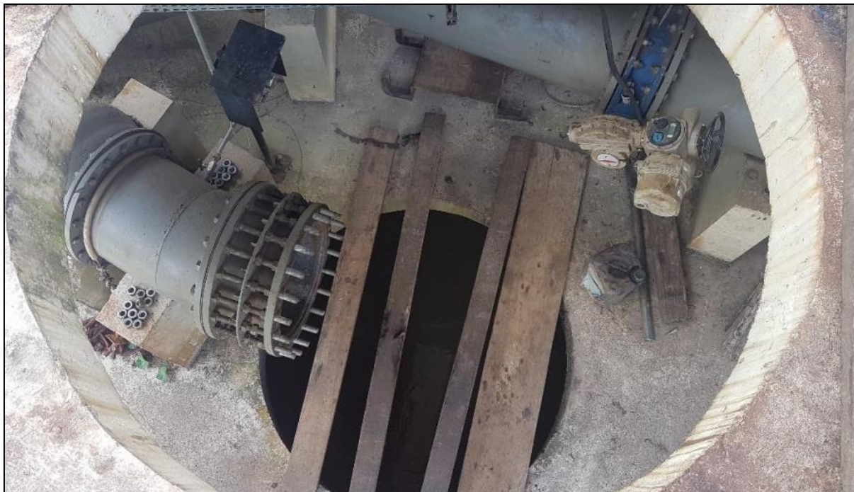
Figura 14 – Poço de Sucção Fonte: PMB (2020)
