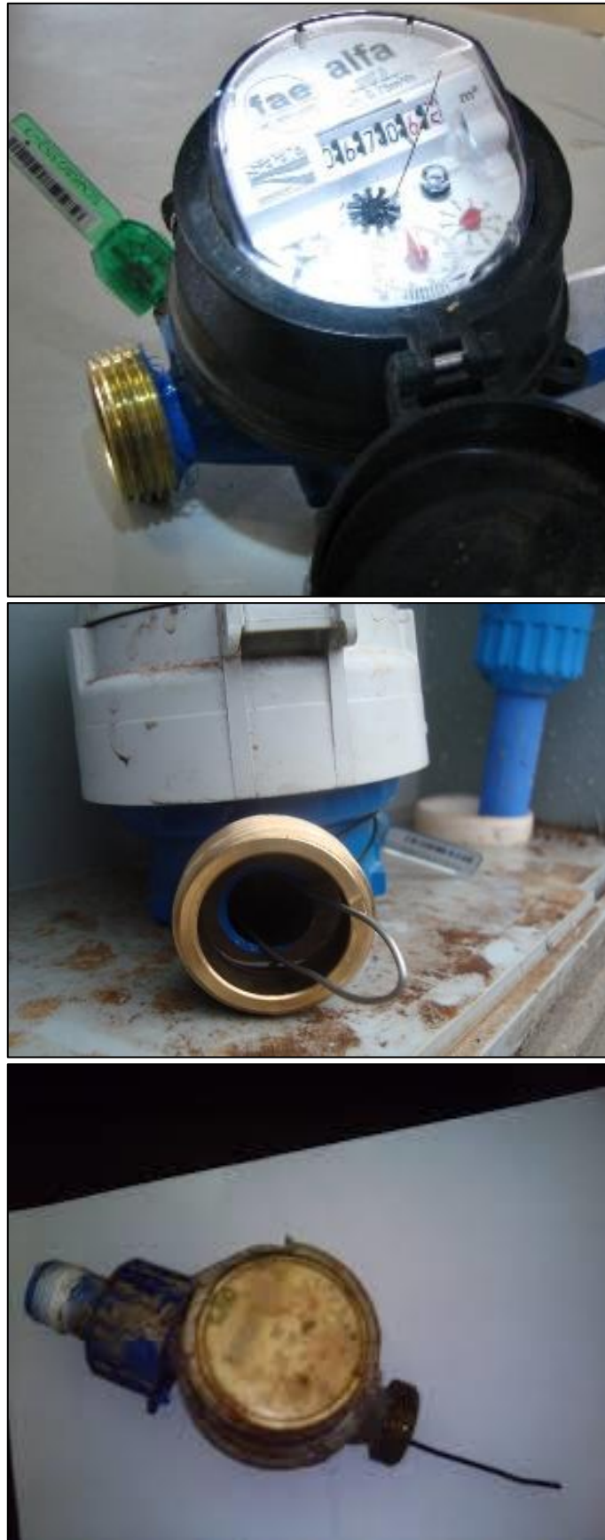
Figura 46 – Hidrômetro Violado Fonte: Autor
