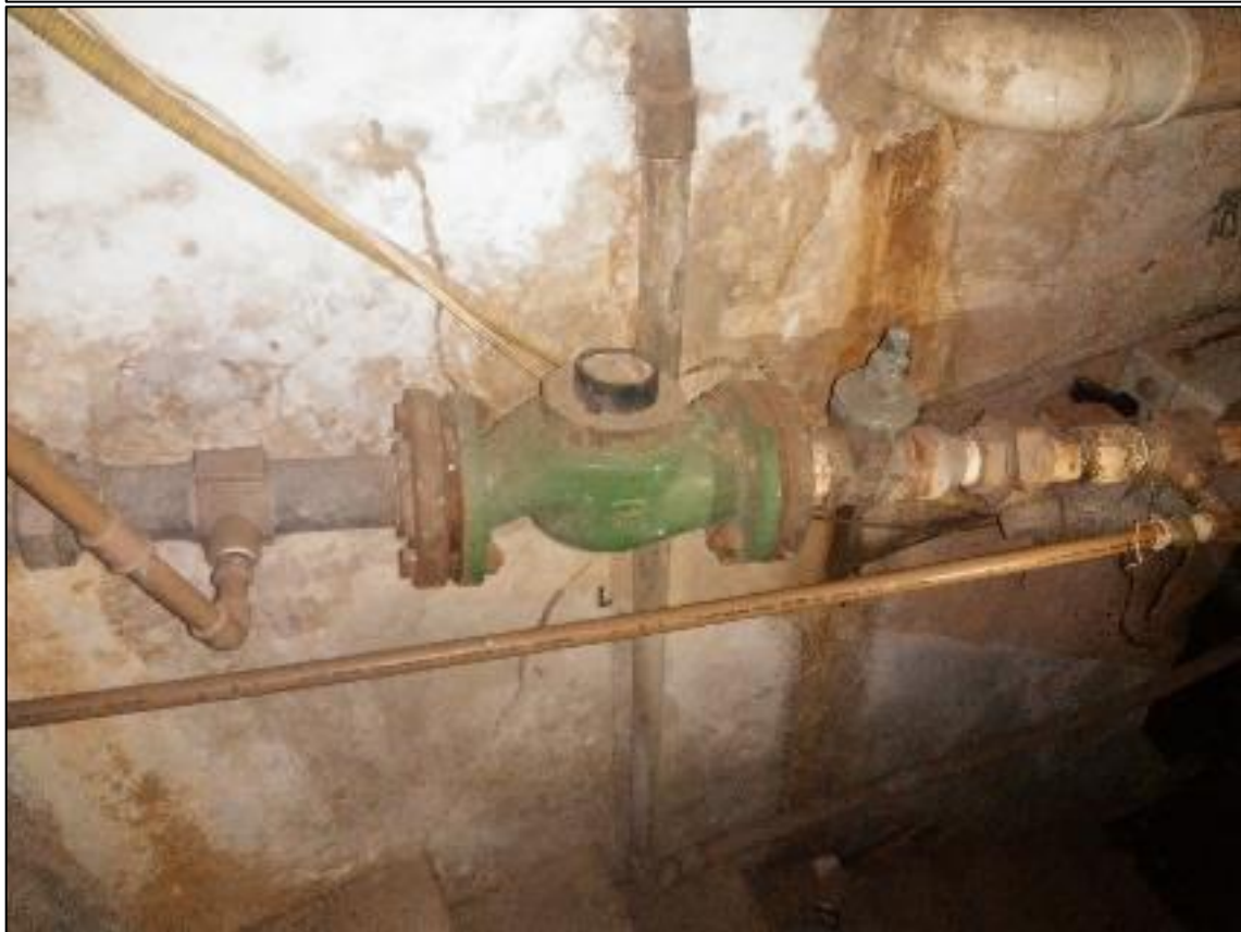
Figura 41 – By-pass Fonte: Autor
