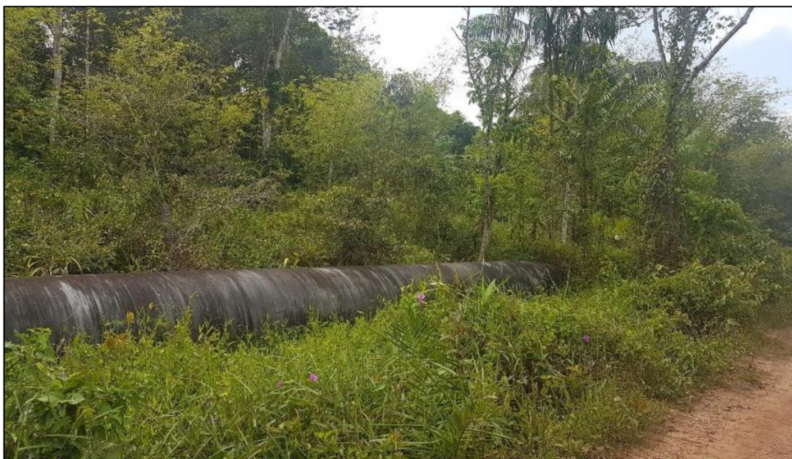
Figura 17 – Adutora de Água Bruta do Rio Guamá Fonte: PMB (2020)
