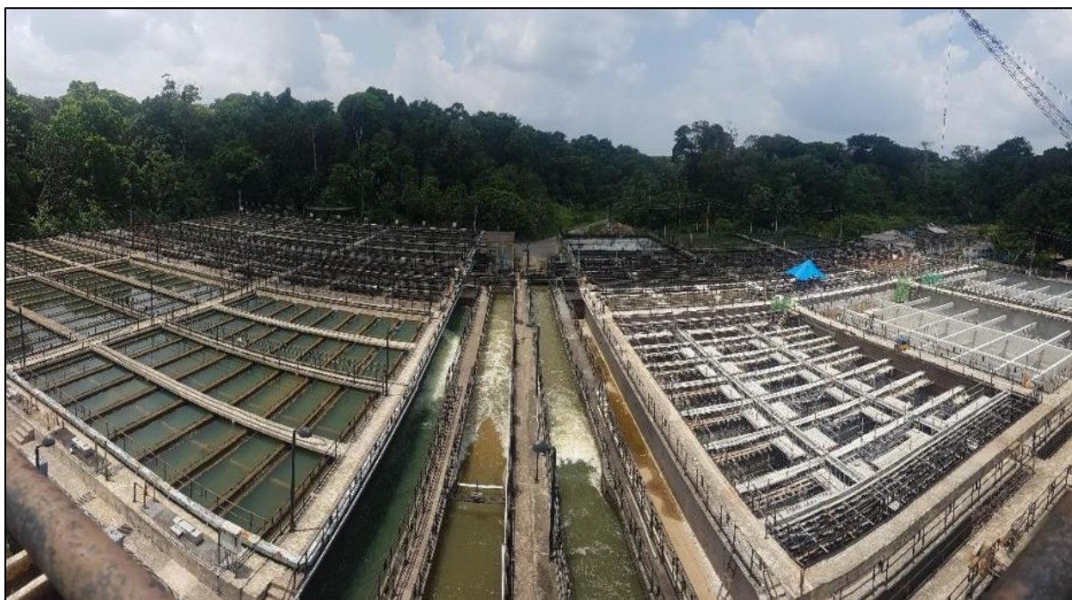
Figura 24 – Módulos 1 e 2 – ETA Bolonha Fonte: PMB (2020)
