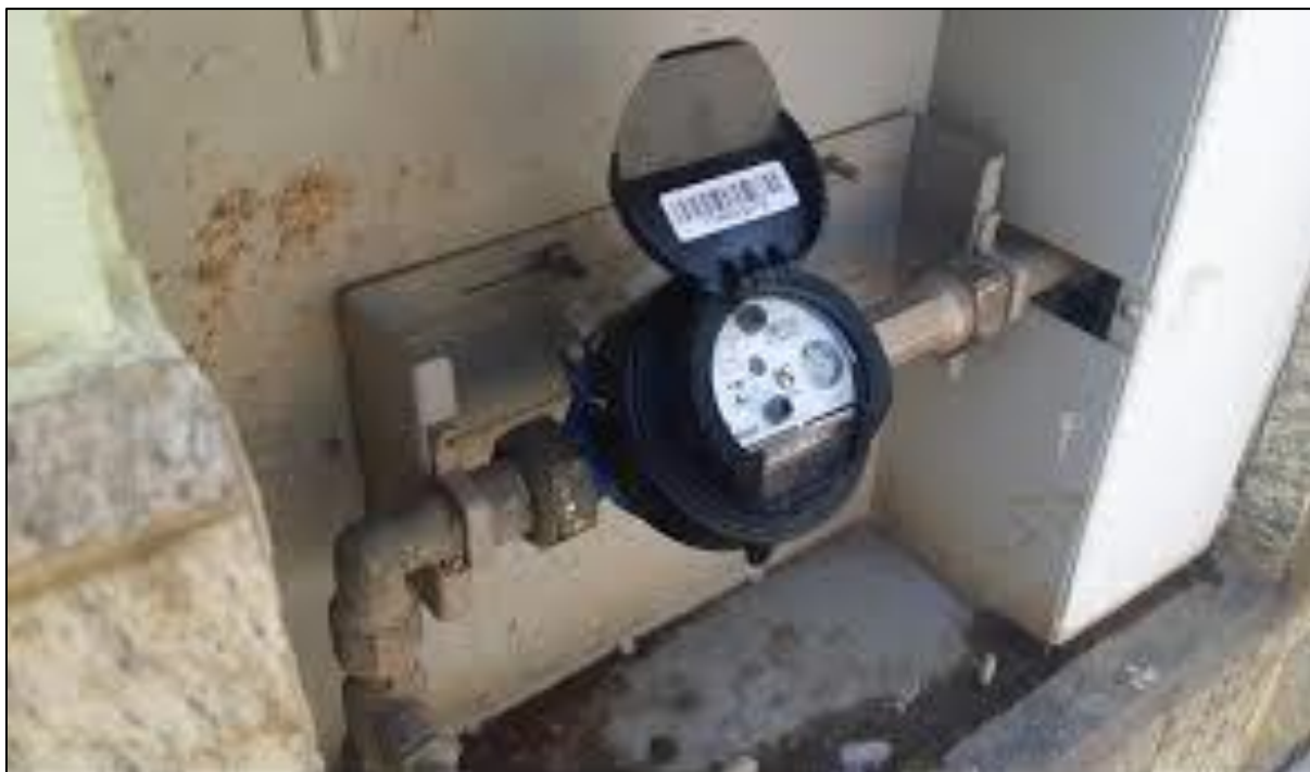
Figura 45 – Hidrômetro Inclinado Fonte: Autor
