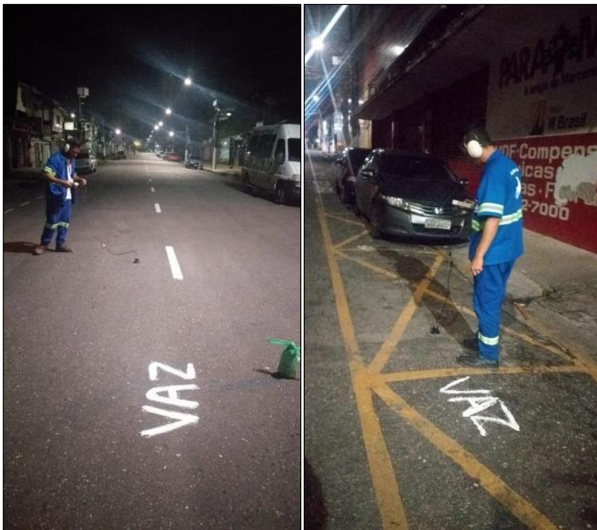
Figura 61 – Marcação de um vazamento não visível em pesquisa noturna Fonte: Autor
