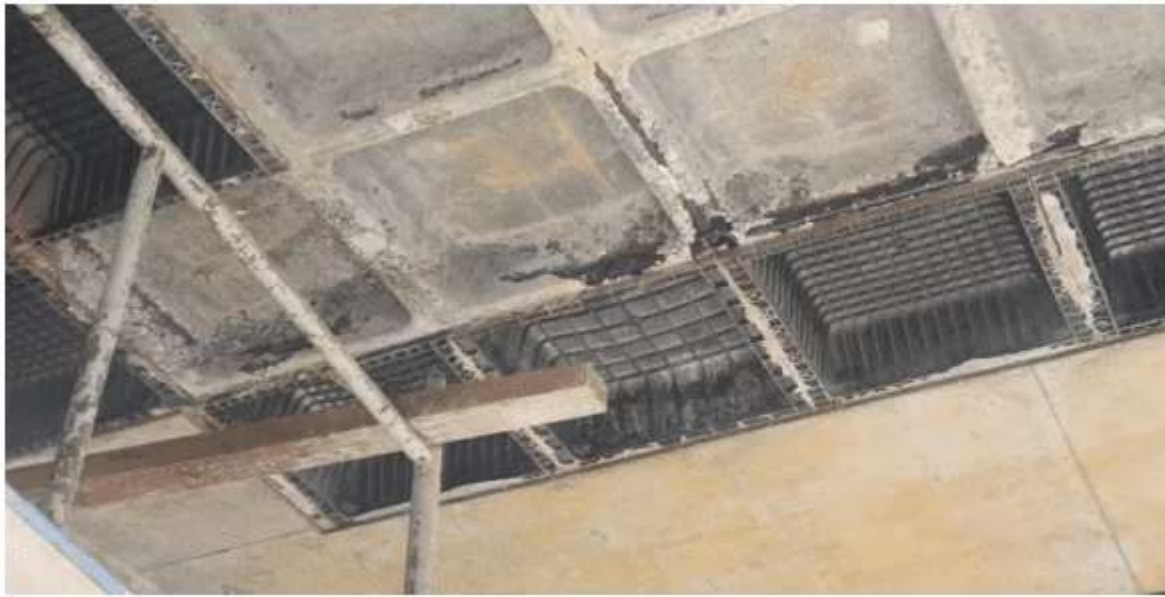
Figura 7 — Segregação em nervuras da laje
