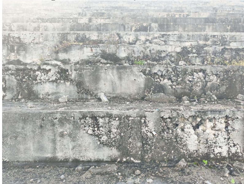
Figura 36 — Deterioração das Escadarias
