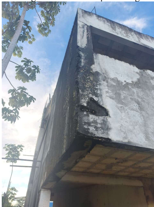
Figura 29 — Infiltração de Vigas
