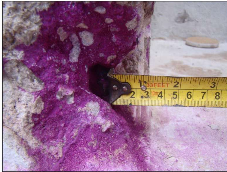
Figura 4 — Estrutura após ensaio de carbonatação
