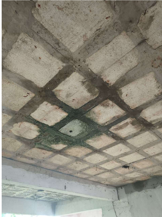
Figura 8 — Manchas na laje nervurada
