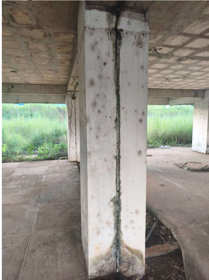
Figura 9 — Manchas na União de Pilares
