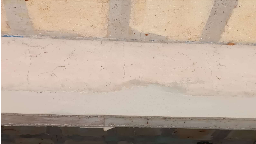
Figura 1 — Fissura em viga estrutural
