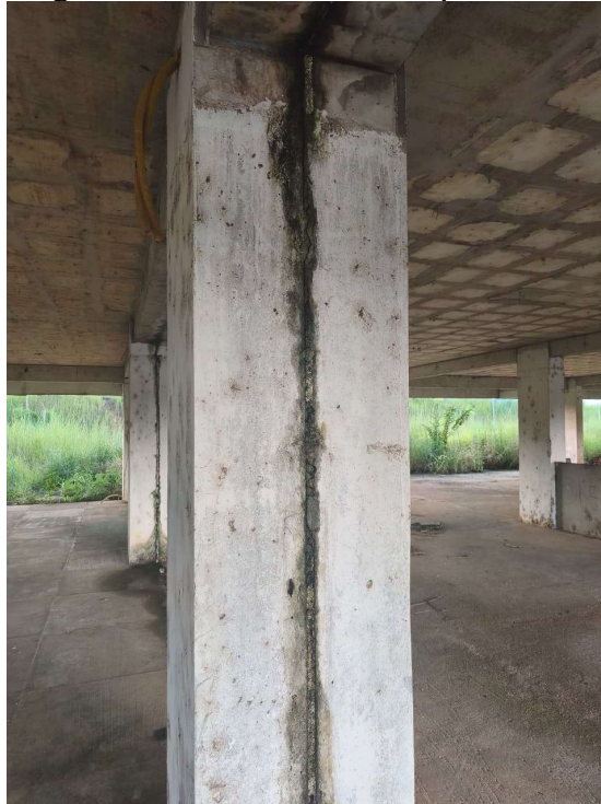
Figura 28 — Pilares afetados por manchas
