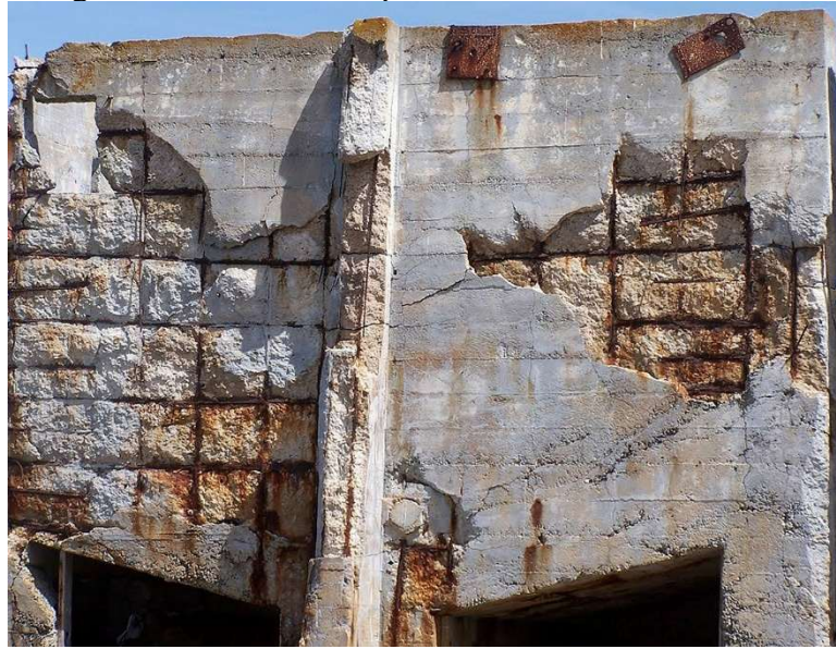
Figura 2 — Estrutura exposta sofrendo com a corrosão
