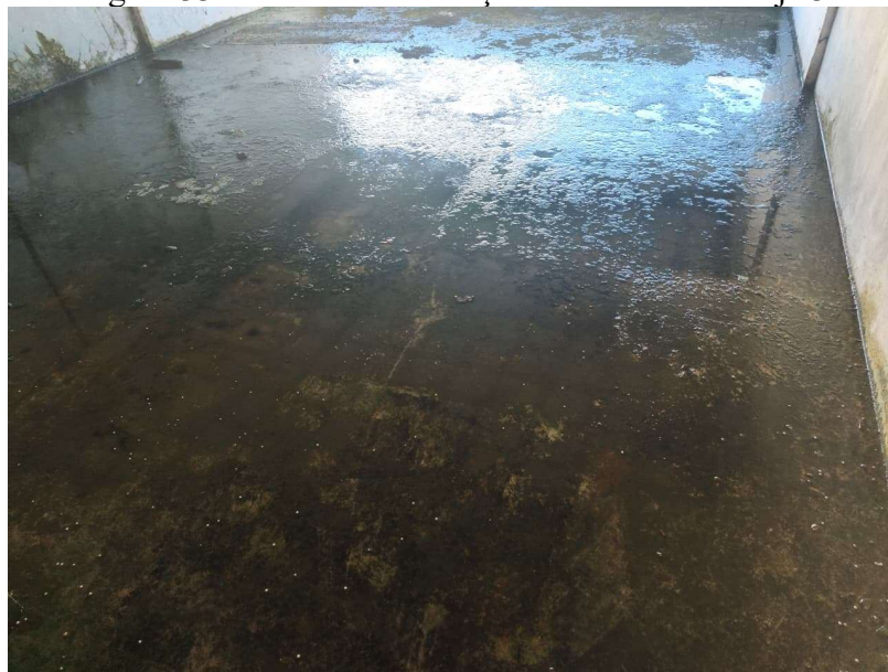
Figura 33 — Grande Infiltração e Manchas na Laje 3
