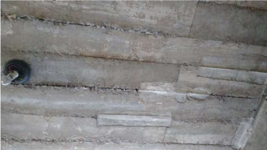
Figura 6 — Cobrimento insuficiente causando corrosão
