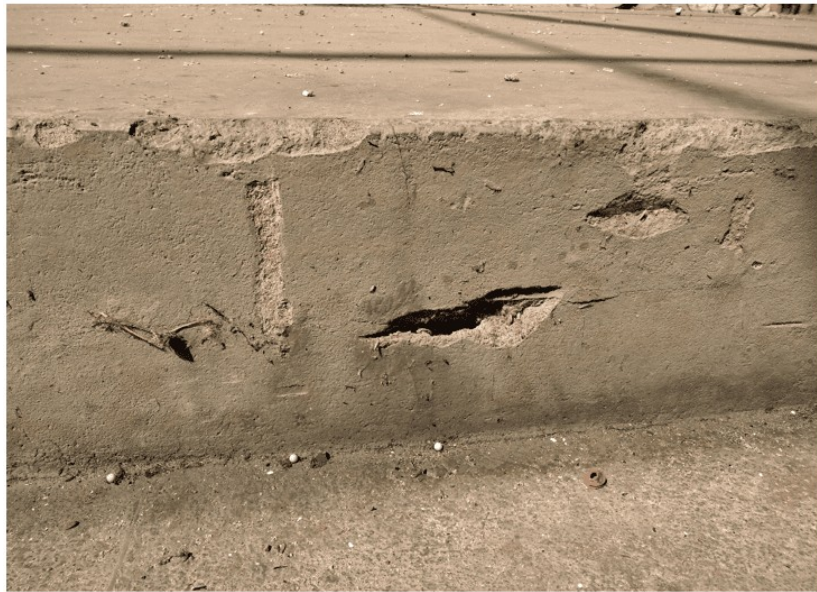
Figura 5 — Desagregação do concreto
