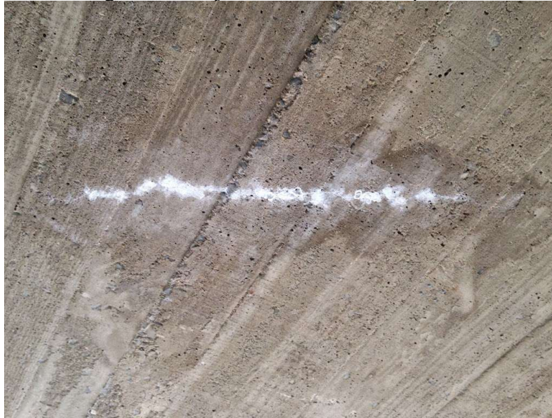
Figura 3 — Laje com eflorescência aparente
