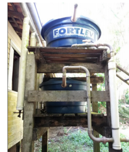
Imagem 97: Estrutura para a armazenagem e filtragem da água da chuva, aplicada na Ilha Grande, Belém (PA). Fonte: Atlas do aproveitamento de água de chuva, Belém (PA), 2016.
