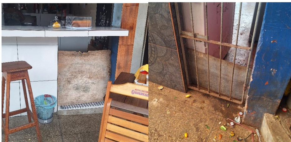
Figura 20 - Placas de proteção nas entradas de alguns boxes fechados
