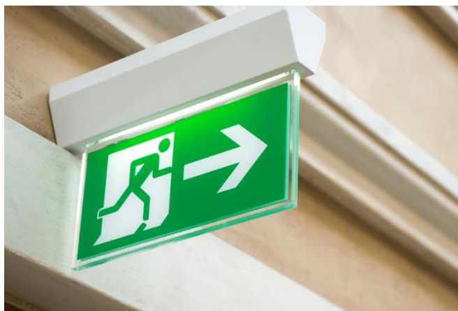
Figura 36 - Luminária de Emergência
