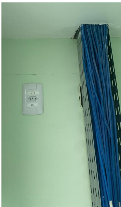
Figura 52 - Chegada dos Circuitos de Lógica na Secretaria
