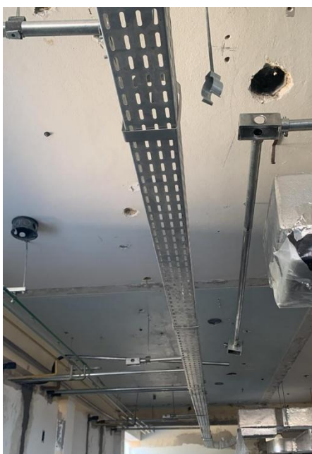
Figura 21 - Eletrocalha 100 x 100 mm
