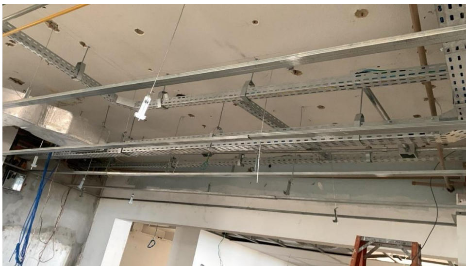
Figura 19 - Tirantes sustentando a infraestrutura elétrica e lógica
