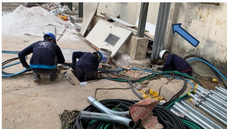
Figura 13 - Passagem dos Alimentadores
