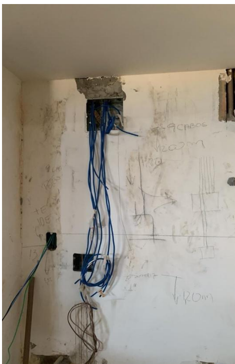
Figura 54 - Chegada dos Circuitos de Lógica no Posto de Enfermagem
