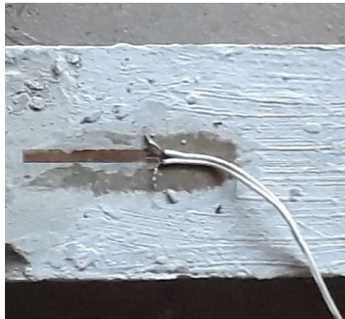
Figura 3.23: Instrumentação da superfície de concreto, com extensômetro fixado na face superior de uma das vigas e soldado a cabos elétricos
