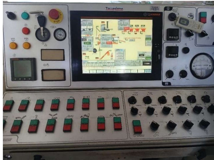
Figura 30 - Painel de controle da cabine
