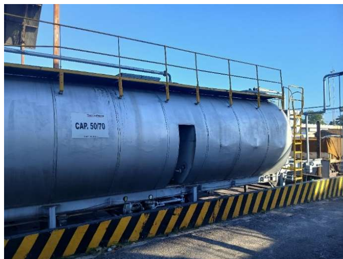
Figura 33 - Tanque para armazenamento do CAP 50/70
