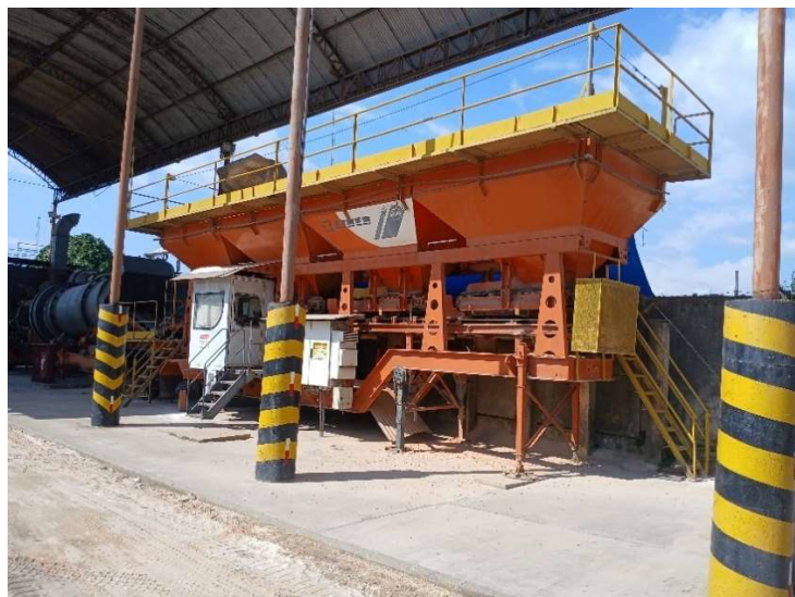
Figura 27 - Silo frio da usina de asfalto
