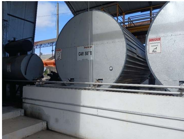
Figura 34 - Tanque reservatório de CAP 50/70
