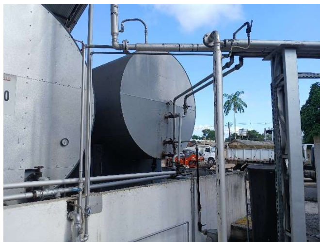
Figura 35 - Reservatório de óleo BPF
