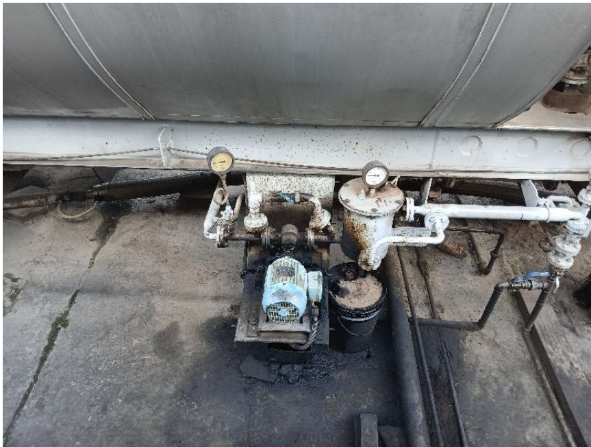
Figura 38 - Sistema de bombeamento e monitoramento de pressão e temperatura
