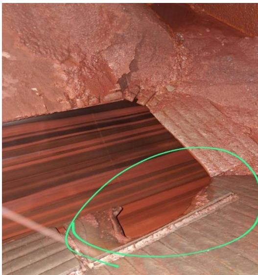
Figura 5: Desgaste do Revestimento (CDP Fe-Cr-C) por abrasão
