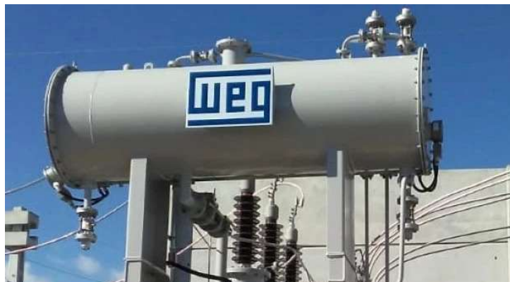
Figura 3 – Tanque de expansão
