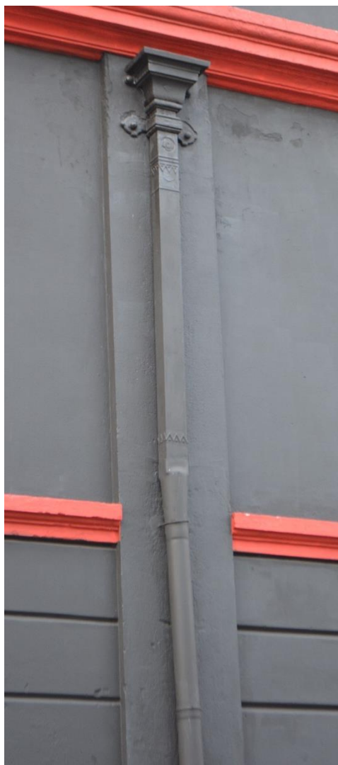
Figura 9. Calha com parte do corpo substituído em PVC. Fotografia do autor.
