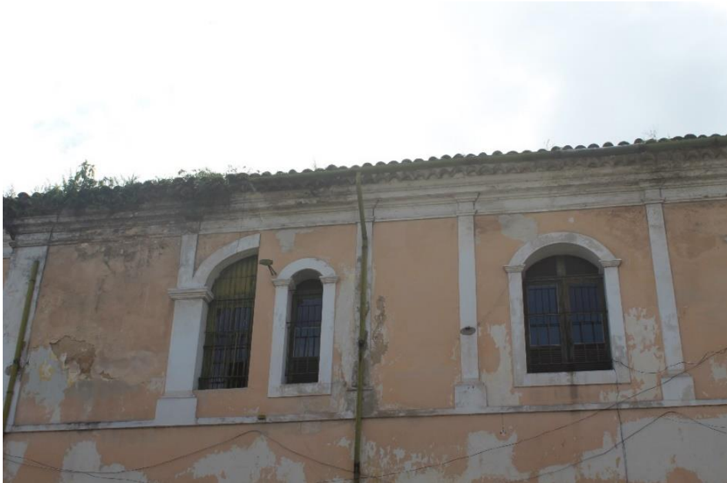
Figura 27: Detalhe onde demonstra-se o vão da janela em arco, que foi seccionado, para a instalação de uma janela para ventilação do banheiro.
