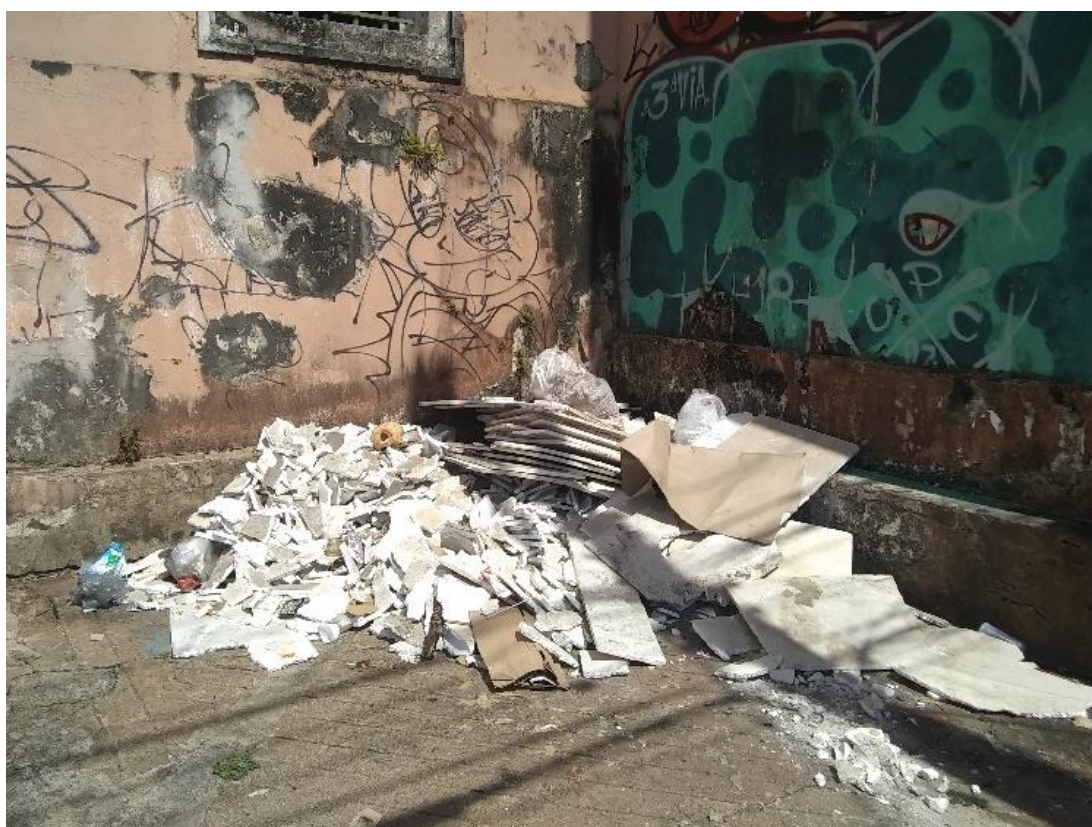
Figura 29: Descarte indevido de lixo na fachada aos fundos da Igreja. Nota-se ainda a presença do picho nas paredes, descaracterizando a edificação.
