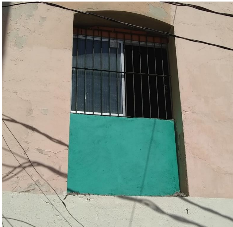
Figura 28: Inserção de elementos incompatíveis, em substituição às balaustradas entalhadas, ao valor documental e arquitetônico da edificação, na livraria Nossa Senhor Rainha dos Corações, como forma de evitar os diversos arrombamentos ocorridos no estabelecimento.
