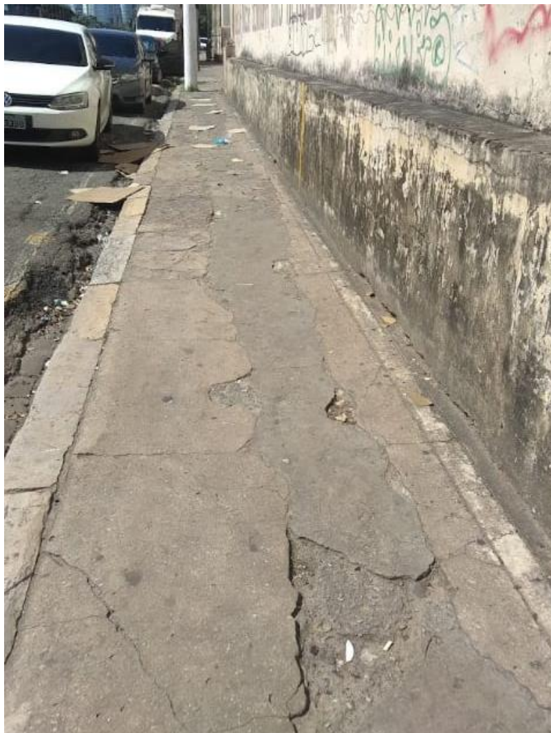
Figura 32: Calçamento na fachada dorsal da Igreja, onde o calçamento em lioz foi quase integralmente substituído por um calçamento em concreto, que encontra desgastes, lacunas e desníveis na maior parte de sua extensão. O meio-fio em lioz é remanescente do antigo calçamento.
