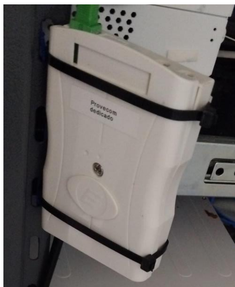
Figura 23 - Caixa de emenda
