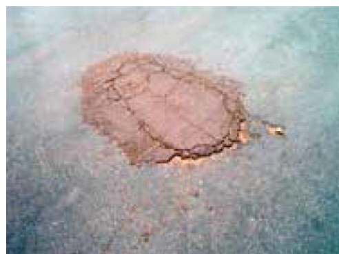
Figura A.11 – Remendo mal executado.
