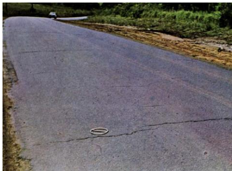
Figura A.1 - Trinca isolada transversal.
