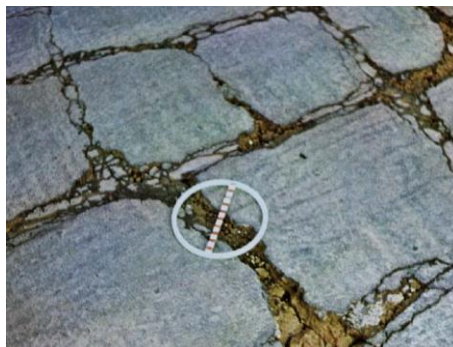
Figura A.4 - Trinca tipo “Bloco”.
