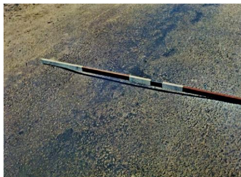
Figura A.6 - Afundamento de consolidação.
