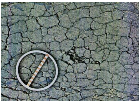
Figura A.3 - Trinca tipo “Couro de Jacaré”.
