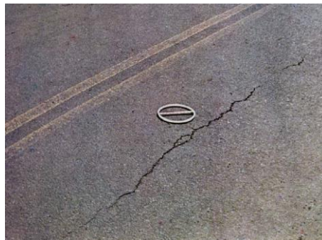
Figura A.2 - Trinca isolada longitudinal.
