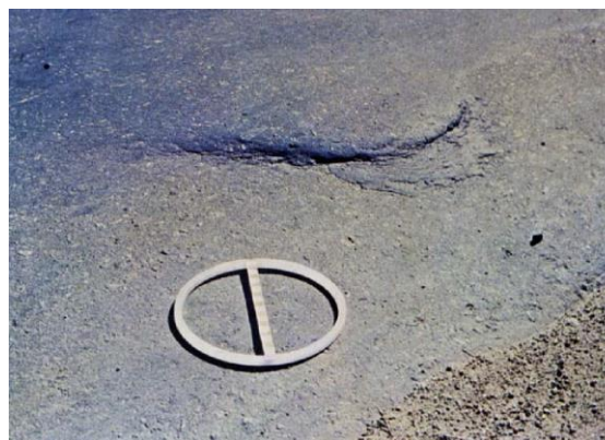
Figura A.8 – Escorregamento.
