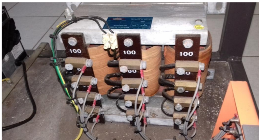
Figura 46. Autotransformador trifásico de partida
