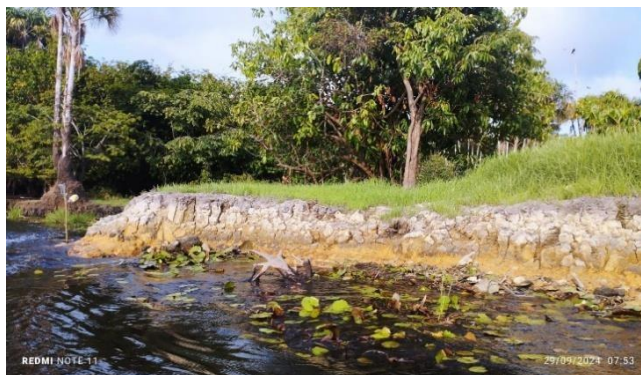
Figura 3: Seca e erosão do solo no igarapé
