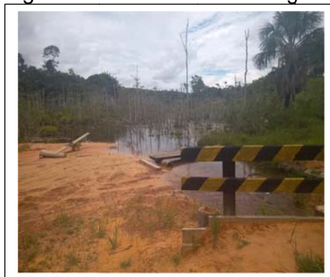
Figura 05: Assoreamento de Igarapé
