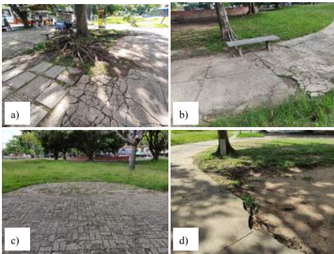
Imagem 35: Condições de piso da praça Dom Mário Miranda de Villas Boas, em Belém, Pará. a) Deterioração a partir do crescimento de raízes das árvores; b) Rachaduras e ausência de piso por desgaste; c) Piso em regular estado de conservação; d) Plano de massa com ausência de gramado.
