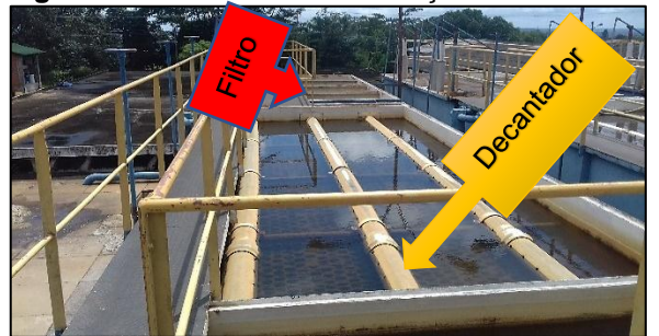
Figura 16 - Unidade de decantação e filtro.
