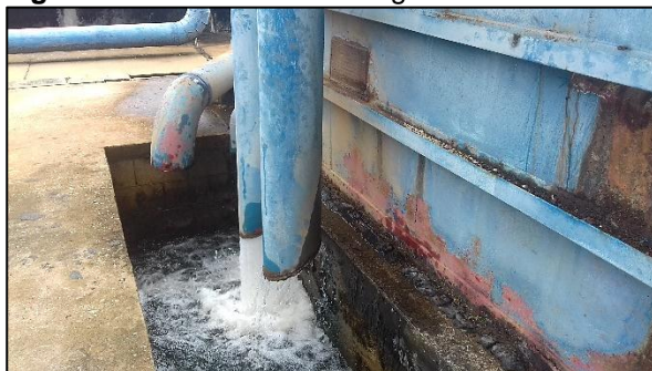
Figura 20 - Pontos de descarga do filtro.
