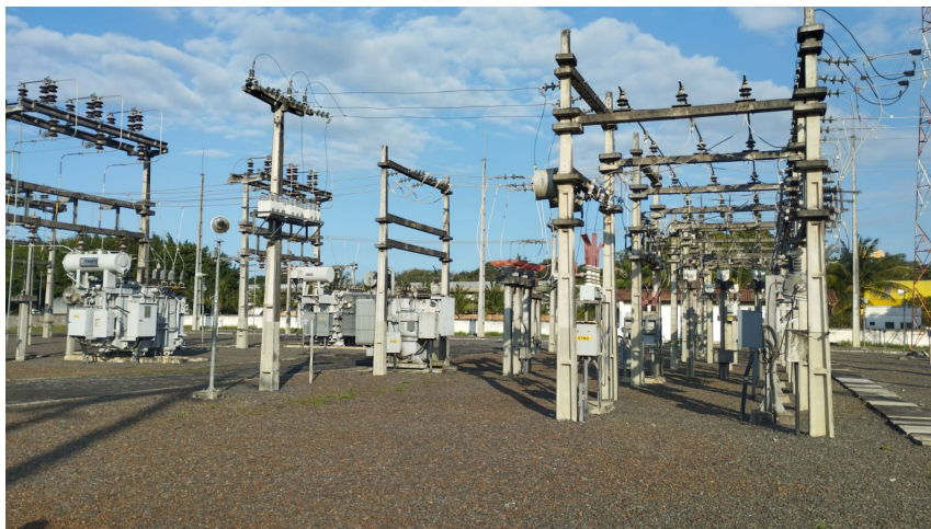
Figura 3 – Subestação e energia de Cruz das Almas
