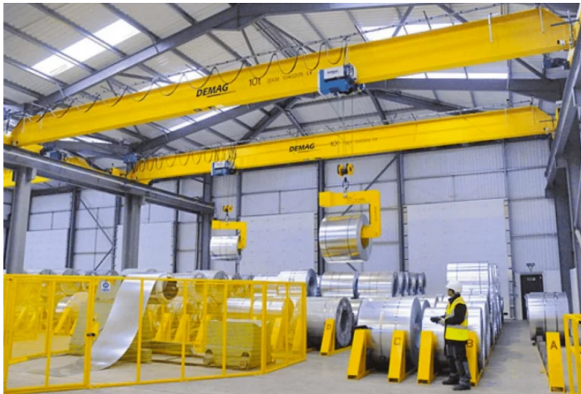
Figura 1 – Ponte rolante utilizada para movimentação de cargas em ambiente industrial
