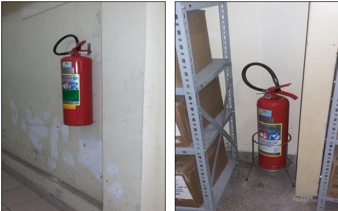
Figura 4 – Extintores nas dependências do Arquivo Geral do TJ-PA.
