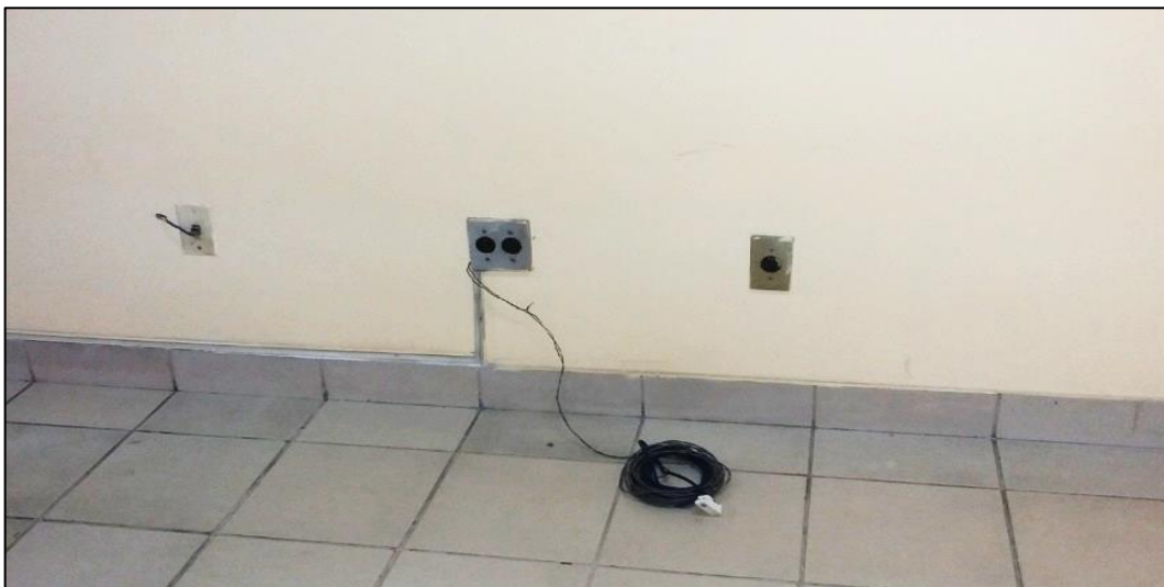
Figura 2 – Instalações Elétricas no Arquivo Geral do TJ-PA.
